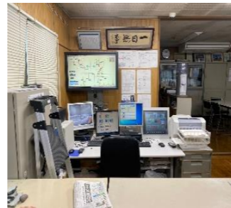
プラント操作盤
